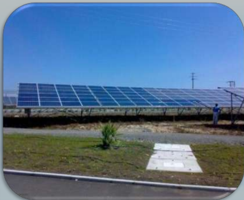
Melilli (SR) impianto da 4,7 MW
