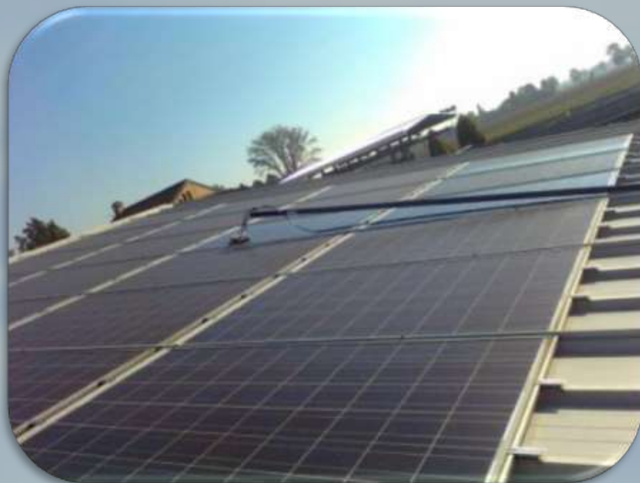
Bologna impianto da 250 kW
