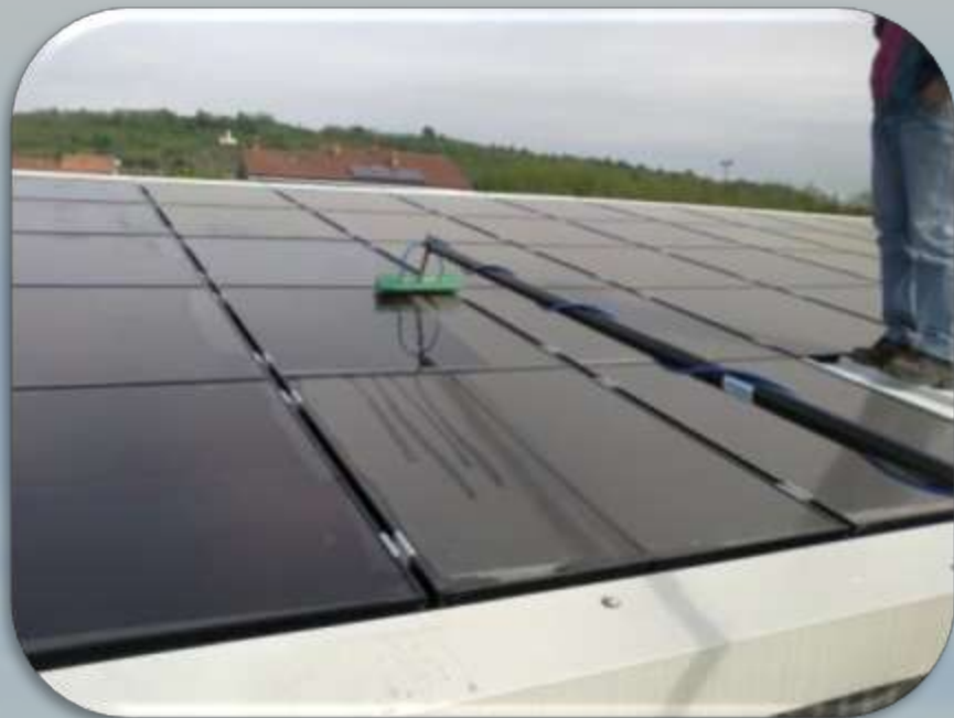
Lugano (SVIZZERA) impianto da 100 kW
