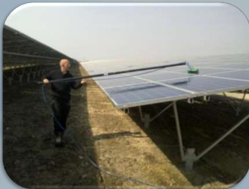
Rovigo (RO) impianto da 70 MW
